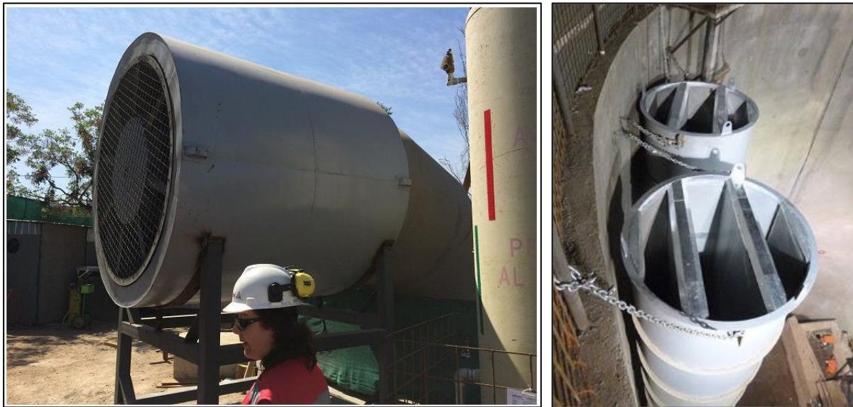
Figura 19: Silenciadores Splitter Cilíndricos en instalaciones de faenas de Metro Extensión Línea 2.
