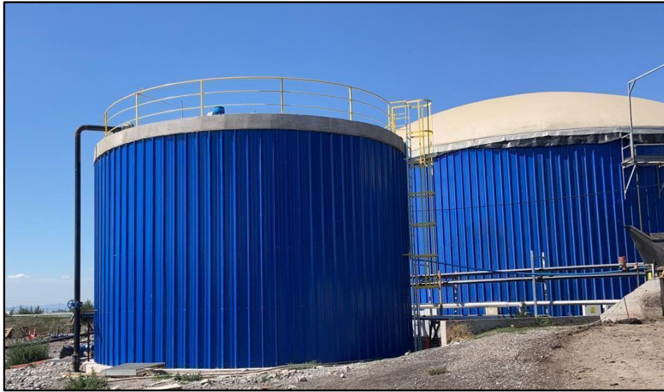
Figura N°6. Estanque de homogenización o premezcla.
