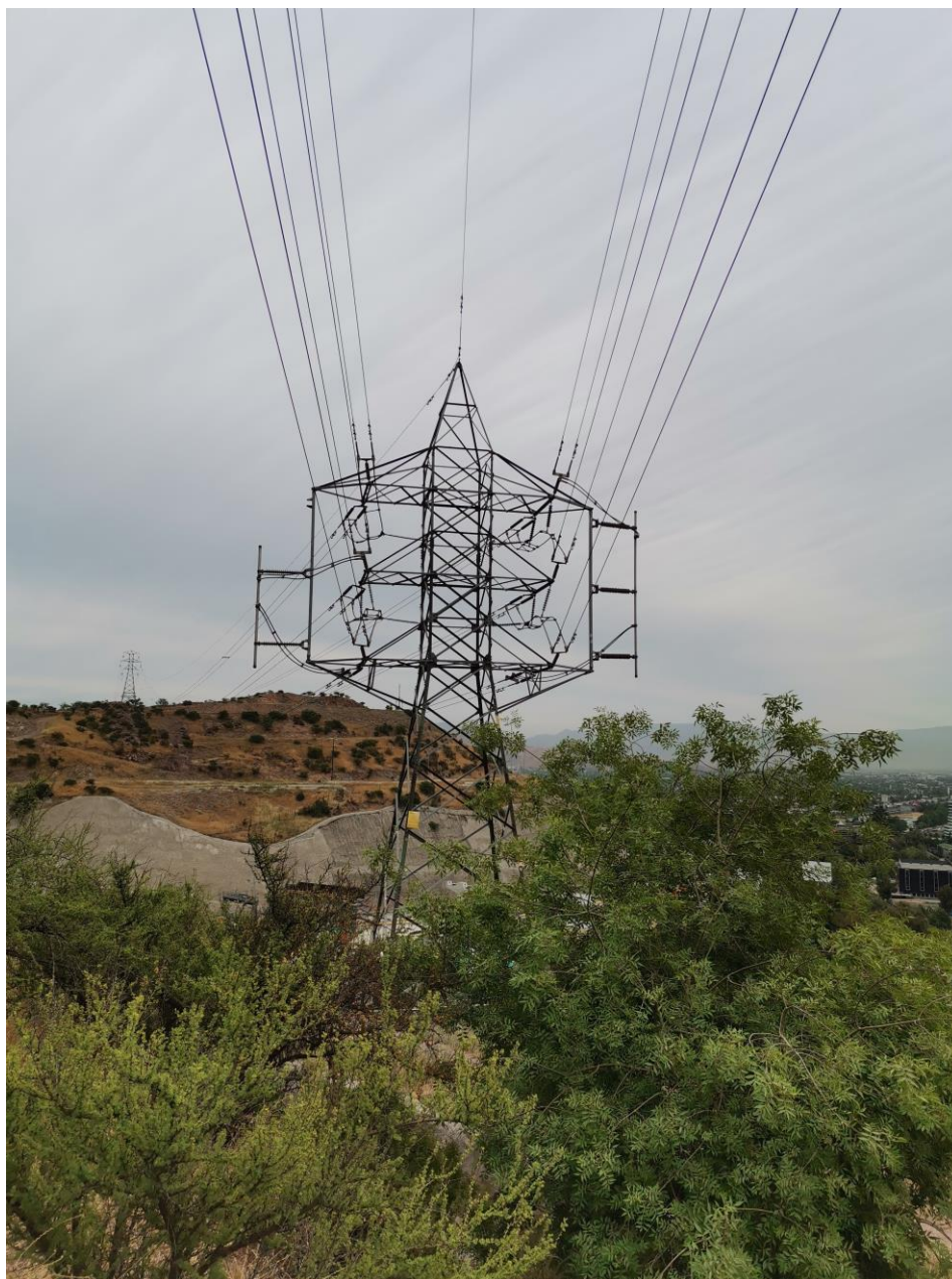
Fotografía 2. Torre actual en LAT 110 kV El Salto – Cerro Navia
