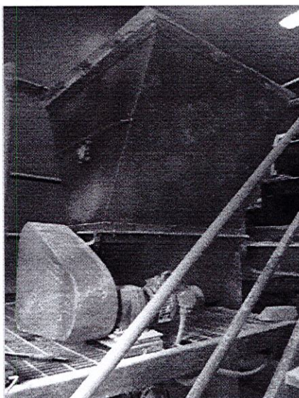
Figura N°2. Tolva dosificadora de hidróxido de sodio.
