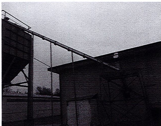
Tramo N° 2 tornillo transportador de Lodos
