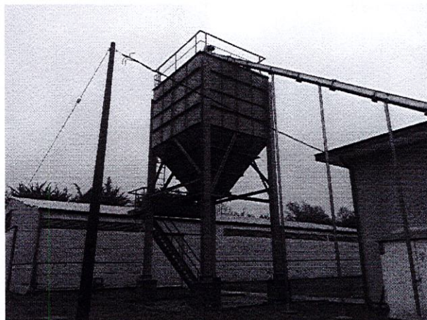
Figura N°5. Tolva de lodos
