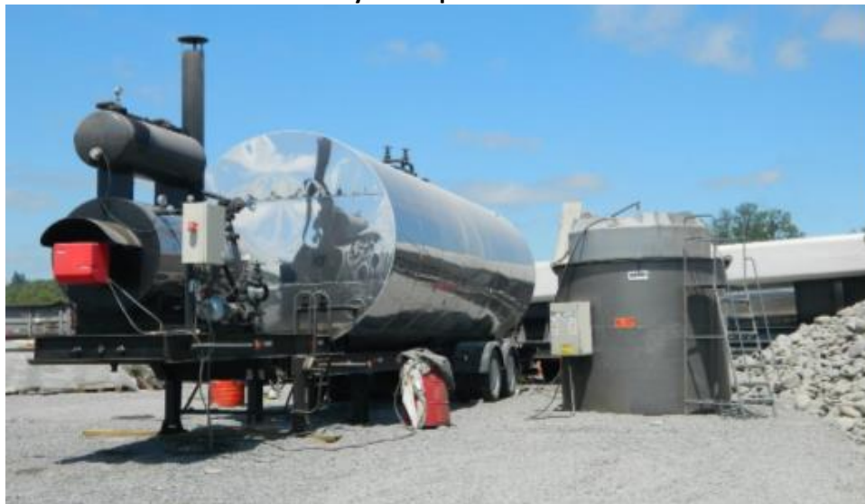
Figura 3-3: Fotografía de la Planta de Asfalto similar a la instalar- Vista desde la caldera y estanco con mezcla asfáltica
